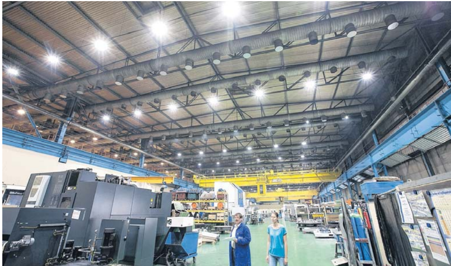
Moderne LED-Lampen leuchten die Produktionshalle der Firma Ermafa Sondermaschinen- und Anlagenbau in Siegmarsdorf besser aus als vorher die alten Hochdruck-Quecksilberdampf-Entladungslampen. Dadurch ist der Stromverbrauch für die Beleuchtung auf die Hälfte gesunken.
